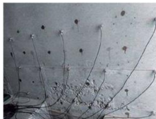
写真-2 変状とセンサの配置状況
