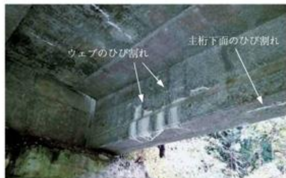
写真-1 PCケーブルに沿ったひび割れ
